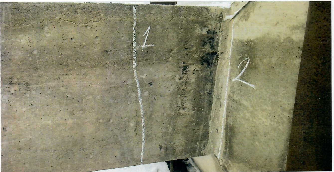
Рисунок 6 – Раскрытие трещин фундамента Ф2-2 при нагрузке 85%
